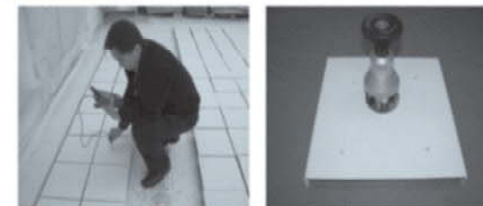
(a) 도막 두께 측정 (b) 부착강도 측정
