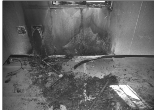
[사진 13] 컨테이너 내측, 유리창 바닥부분의 연소형태
