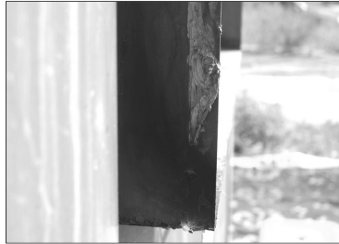
[사진 6] 사진 4 □부분, 외측 하단부분의 연소형태
