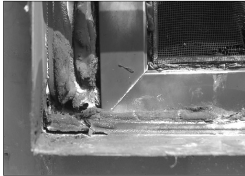
[사진 5] 사진 4 □부분, 유리창틀 좌측 하단부분의 형태
