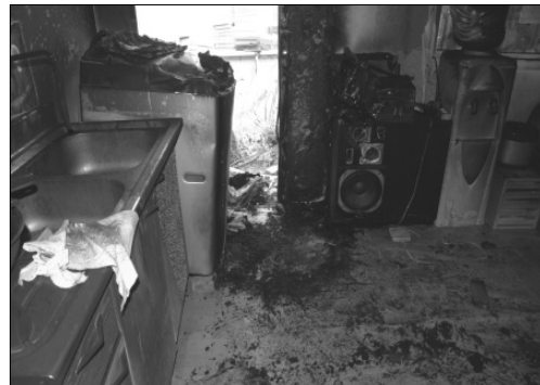
[사진 16] 컨테이너 출입문 하단부분의 연소형태
