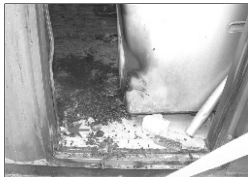
[사진 18] 컨테이너 출입문 바닥부분의 연소형태
