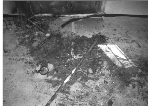
[사진 14] 컨테이너 내측, 유리창 바닥부분의 연소형태
