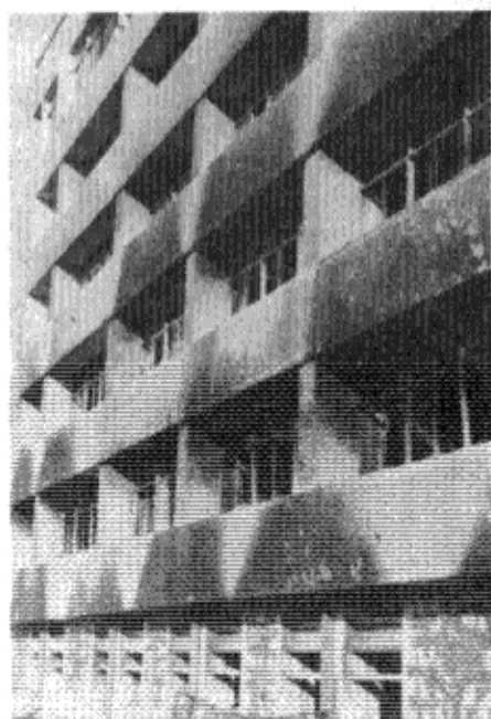
火災後 建物外觀(西側面)
