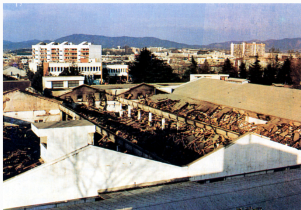
▲ 火災工場全景
