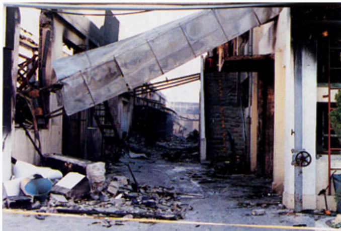
〈연소확대의 원인이된 컨베이어 시설〉 16동과 15동은 약 5m정도 떨어져 있었으나 이 컨베이어와 마주보는 외벽의 개구부를 통하여 연소확대되었다.
