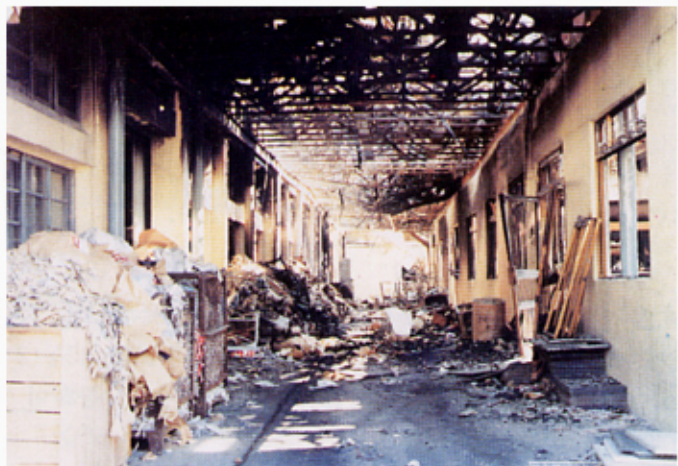
〈16동과 17동사이의 통로〉 통로부분을 철골트러스로 연결시키 놓아 외벽을 통한 연소확대가 용이하였다.
