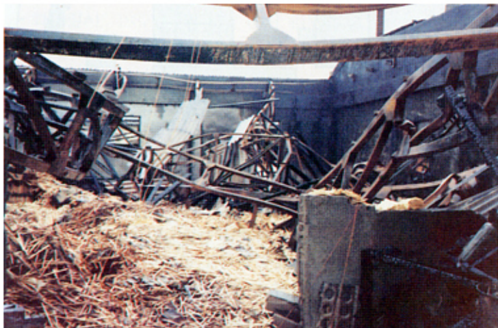
〈진화후의 공장내부〉 언뜻 헛간을 연상케 한다. 사진 우하는 업체간에 설치된 간벽으로 연소확대방지에 활용되지 못하였다.
