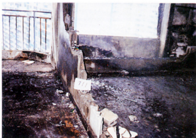
〈발화세대의 내부벽체 도괴상태〉 내부벽체는 시멘트 블럭이었다.
