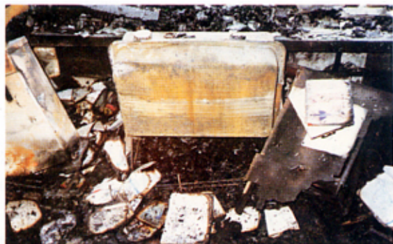
↑ <보일러용 연료용기> 80ℓ 용량의 석유용기는 아무런 안전 조치없이 보일러와 함께 거실에 설치, 사용되었다.
