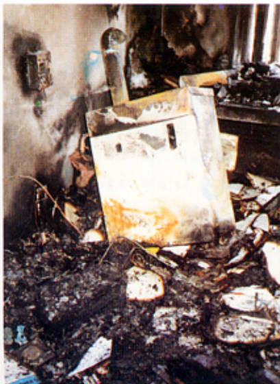
↳ <한 가정을 비탄에 빠뜨린 화재원인의 보일러> 거실에 설치된 이 보일러에서 화재가 발생하여 잠 자고있던 일가족 중 딸 2명이 소사하였다.
