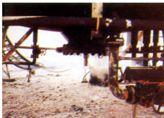
〈사고탱크의 일부분〉 Ball Tank와 Drain Pot의 연결배관 용접부위가 절단, 탈락되었다. Drain Pot는 보이지 않는다.
