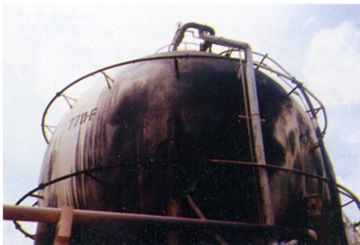
(Ball Tank의 파열부분) 사진의 우측 상단부분이 30cm정도 L자형으로 파열되었으나 사진상에는 잘 나타나지 않고 있다. 파열시 폭발현상이 있었으나 폭발력이 약했으며 이후 화재가 급격히 약화되었다. 탱크 주위의 Ring배관은 물론무실비로서 탱크의 폭발방지에 기여하였다.
