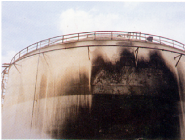
〈나프타 탱크의 열손 모습〉 바람부는 방향에 설치 되어 장시간 열을 받았다.
