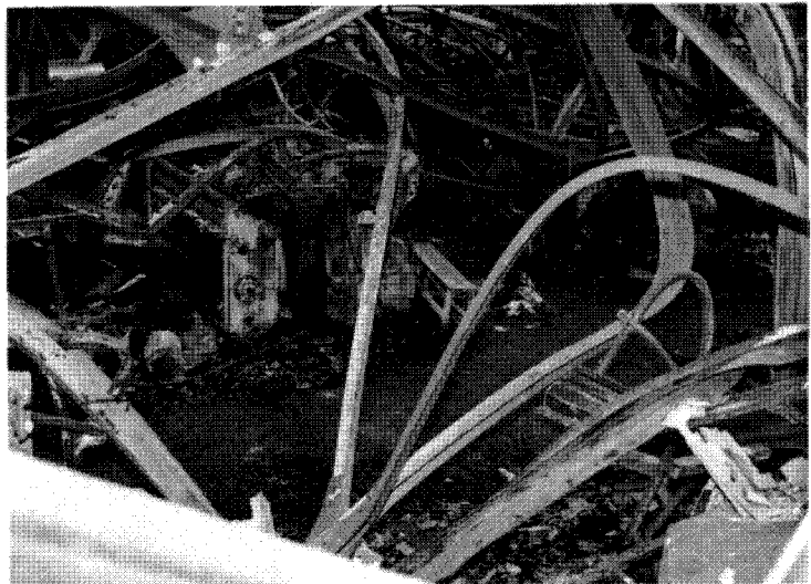
〈소실된 공장 내부〉 철골트러스가 엇가락 처 럼 내려 앉아있다.
