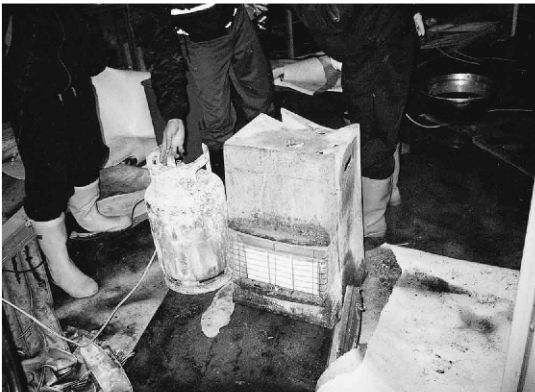
[그림1. 지하1층 휴게실의 LPG히터]
