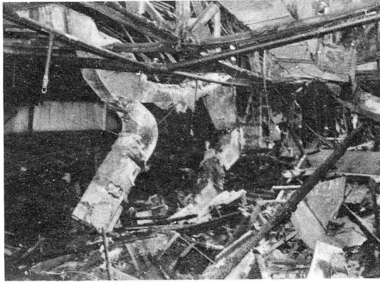
내부 소실 및 스프링클러 배관 (헤드 개방됨)
