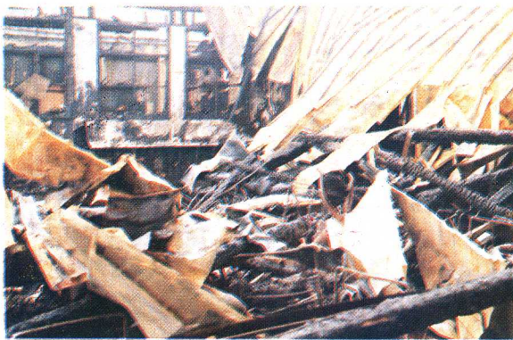
◀ 燒盡되어 내려 앉은 2層의 바닥과 天井
