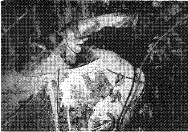
사진1. 반응기부속장치의 폭발로 파괴 절단된 반응기와 전선배관들. (전선 절단시 쇼트에 의한 불꽃이 화재의 원인이 된 것으로 추정됨)
