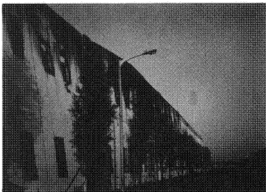
화재후의 소손된 공장 외벽 화재로 열을 받아 공장 외벽이 비스듬히 기울어 있다.
