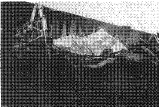
발화장소로 추정되는 자재창고부분의 지붕붕괴모습 사진 윗부분에 보이는 벽과 창문은 주방기 공장과의 경계로서 이 부분으로 화재가 공장으로 확대되었다.
