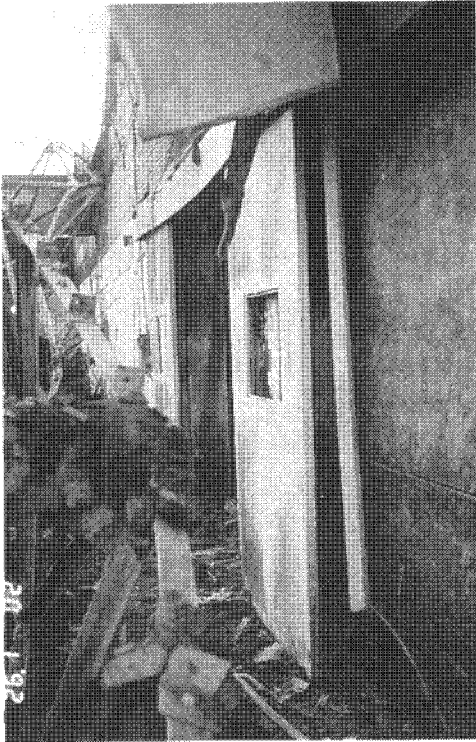
* 방화문에 창이 있고 자동폐쇄가 되지 않는 구조여서 연소확대의 통로가 되었음.
