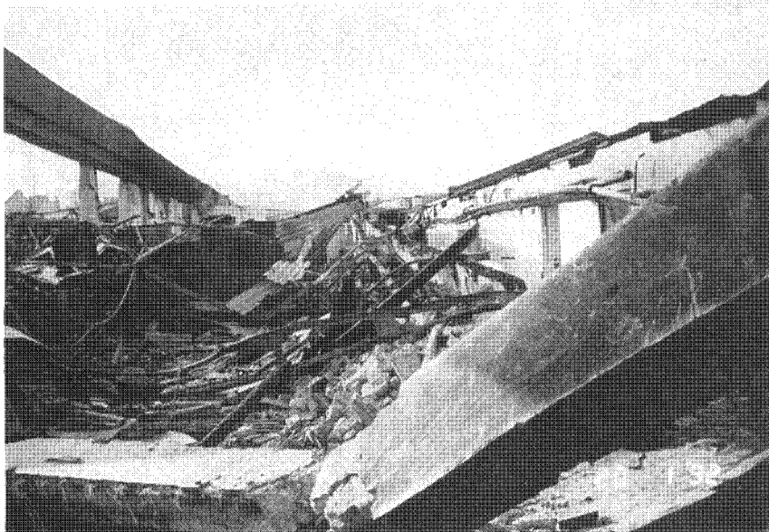
* 수열량이 많은 보은 도괴하였으며 철골 트라스는 완전히 붕괴됨
