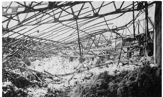
철골 트러스가 완전히 내려앉아 버렸다.
