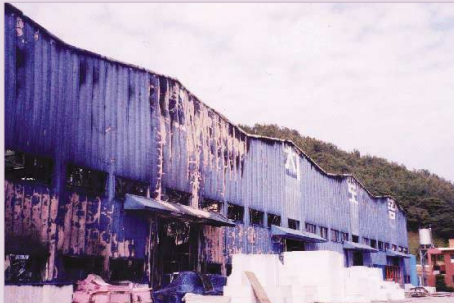
[사진 1] 화재 후 공장 전면부
