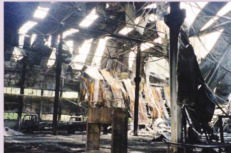
[사진 4] 건물 지붕 및 외벽 소손 모습
