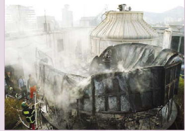
[사진 8] 화재진압 후 잔해정리 모습
