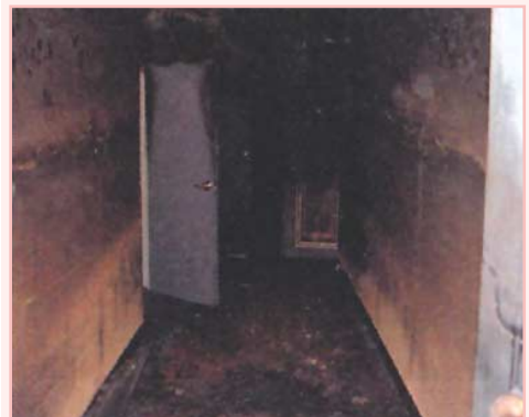
[사진 6] 3층 복도 소손 흔적
