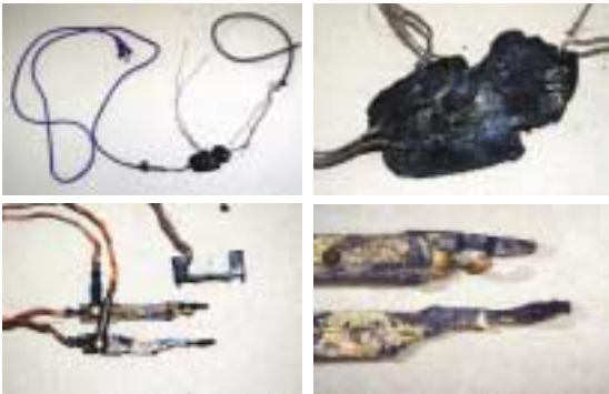
■ 사진 10. 멀티콘센트 내부 단자 사이에서의 단자간 트래킹에 의한 발화 흔적
