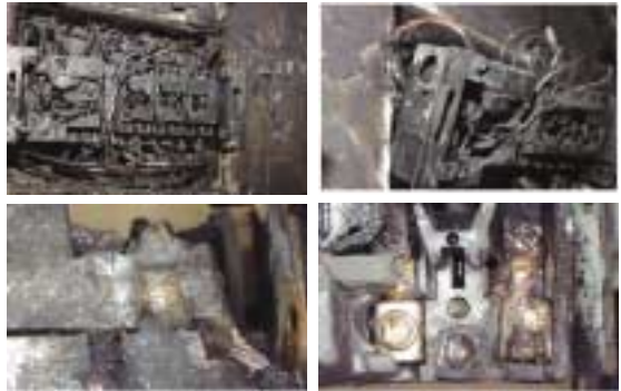
■ 사진 12. 소화작업 중의 주수에 의해 형성된 분전반의 트래킹 현상
