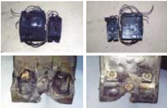
■ 사진 11. 차단기의 출력측 단자 부분에서의 트래킹 흔적
