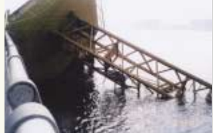
■ 크레인 도괴 장면
