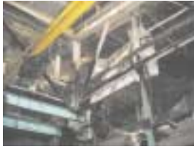
■ 사진 2. 상부 철골보 소손 모습
