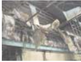
■ 사진 3. 발화지점 벽체 상부 소손 모습
