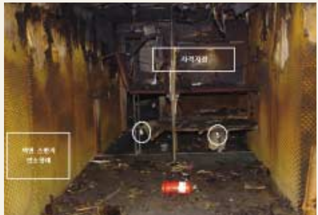
■ 사진 2. ABC분말 축압식소화기(안전요원이 피난 중 버림)
