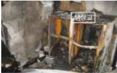
■ 사진 1. 벽면 및 냉장고 소실 모습
