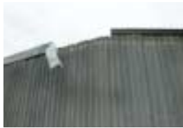
● 사진 6 ● 지붕 Flashing 파손
