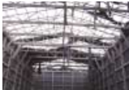
● 사진 8 ● 천막 지붕 파손
