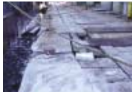
● 사진 2 ● 선박 총돌로 안벽 파손
