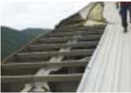
● 사진 5 ● 지붕 가장자리 탈락
