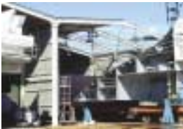
● 사진 1 ● 공장동 지붕 컬러 강판 파손
