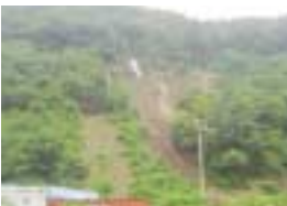
● 사진 9 ● 산 중턱 경사지 붕괴
