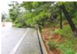
● 사진 10 ● 도로 주변 경사지 붕괴
