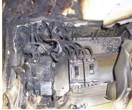
〈사진 3〉 누전차단기함 위쪽 벽면 'V' 패턴이 발견된 사진.
