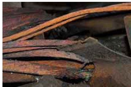
<사진 10> 지하 전력 공급 장치로부터 배선된 케이블의 절연손상에 의한 발화
