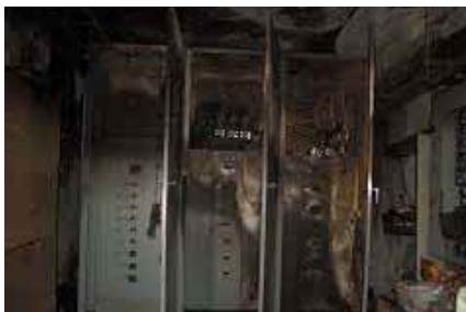
<사진 9> 빌딩 지하의 전력 공급 장치 내부 (상시 관리가 어려운 환경)
