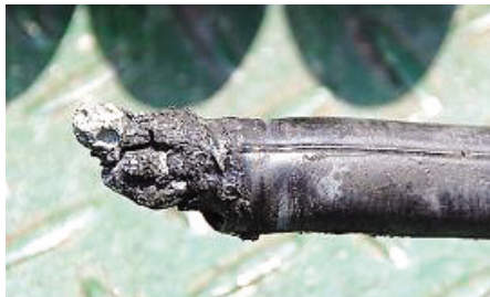
[사진 4] 낙뢰에 의해 단선된 후 지락에 의한 용융흔
