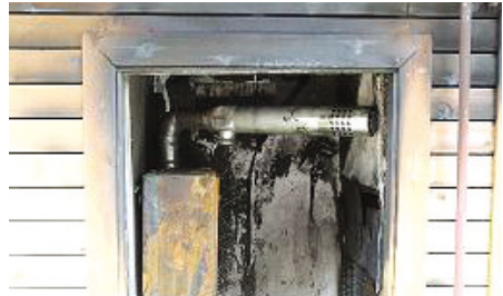
[사진 7] 가스 누출에 의한 발화로 연소된 보일러실
