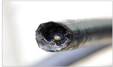
[사진 3] 낙뢰에 의해 절단되면서 발생한 아크 방전흔
