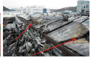
〈사진 7〉 바람이 불어가는 쪽 공장 연소확대 현장
