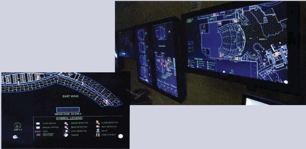
[사진 1] 시티센터의 중앙 화재 통제실은 여러 개의 대형 터치스크린 패널(오른쪽)을 사용한 통합 화재경보 시스템이 그 특징인데, 경보, 감지기, 스프링클러설비, 옥내소화전, 제연팬 등의 위치와 상태 등을 각각의 건물 도면상에서 자세하게 보여 준다(왼쪽). 동일한 화재경보 시스템이 예비 방재센터로 시티센터의 또 다른 곳에 설치되어 있다.
