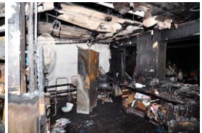
[사진 6] 1층 사무실, 출입구 방향의 연소상황
