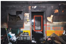
[사진 9] 1층 제①노인생활실 출입구 주위 연소상황
