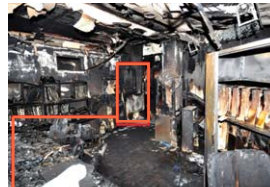
[사진 5] 1층 사무실, 분전반 방향의 연소상황
