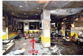
[사진 3] 1층 사무실측 방향의 연소상황
