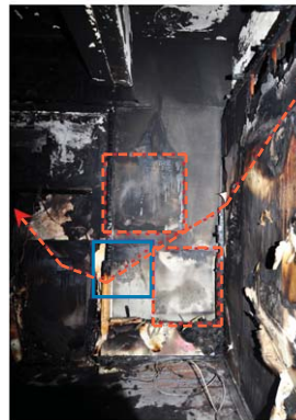
[사진 7] 사무실 분전반 주위의 연소상황(표지는 분전반 설치 위치)
