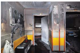
[사진 11] 1층 제②노인생활실 출입구 주위 연소상황
