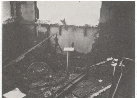
회게 보이는 벽면이 화재가 발생한 장소로 추정됨.
