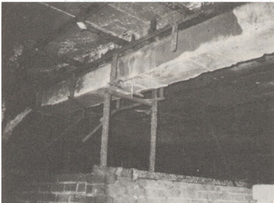
높은 열에 의하여 보에 균열이 생겼다. (중간부분)
