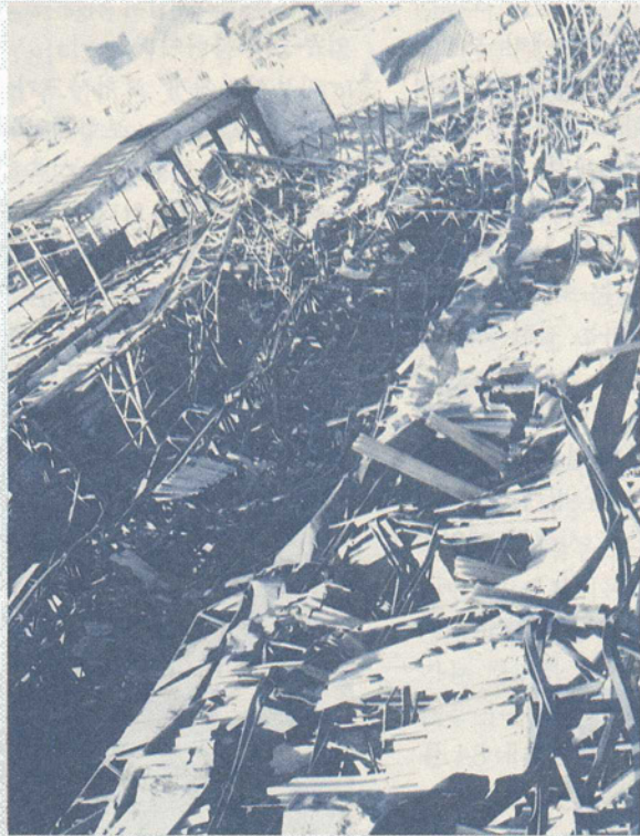
◀ 불길에 녹아 붕괴된 철골 지붕 트러스
